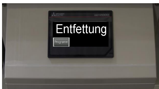
Prozessbedientableau zur Prozesssteuerung (Beispiel: Entfettung)
