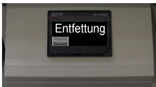
Prozessbedientableau zur Prozesssteuerung (Beispiel: Entfettung)
