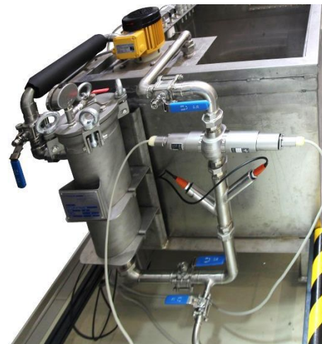
Beutelfiltereinheit und Sensoren zur Überwachung des Beschichtungsbad
