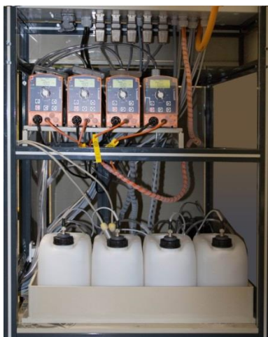
Innenansicht der PRS: Dosierpumpen und Reservoirs für die Regulierchemie des Beschichtungsbad
