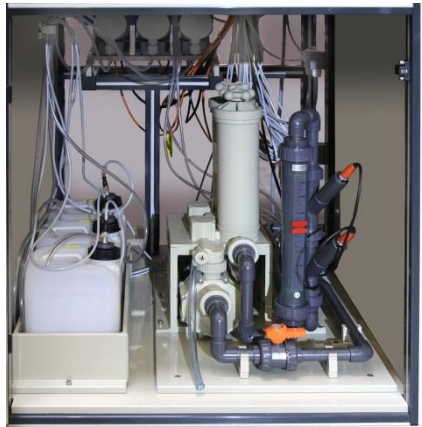
Innenansicht der PRS mit Vorratsbehältern für Elektrolytkonstanthaltung und pH-Regulierung, Dosierpumpen, Umwälzpumpe M50, Kerzenfiltereinheit 2 x 10", Durchflussmesser und Durchflussmengenventil
