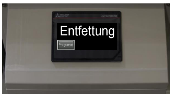
Prozessbedientableau zur Prozesssteuerung (Beispiel: Entfettung)
