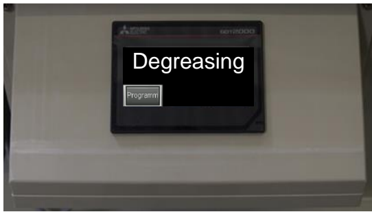
控制操作的控制面板（例如：去脂） Control panel for process control (Example: degreasing)
